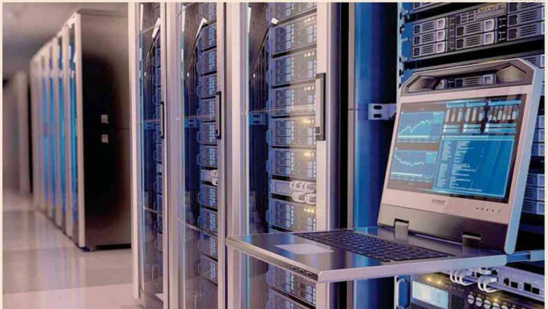
Servizi cloud. Il Polo strategico sarà un insieme di quattro data center
