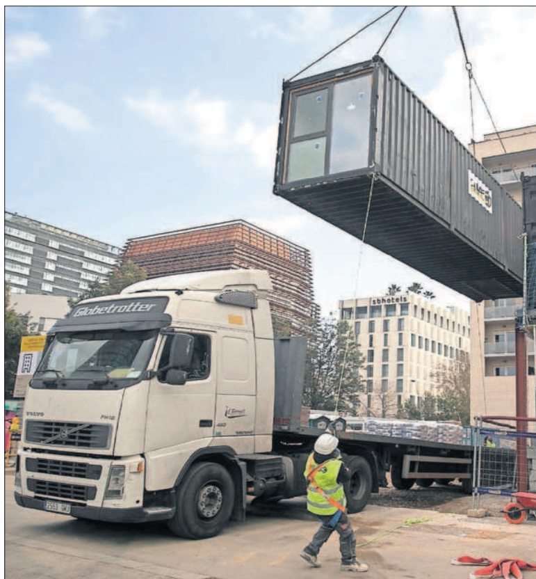
Instalación de contenedores en un edificio de pisos sociales en Barcelona. / MASSIMILIANO MINOCCI
