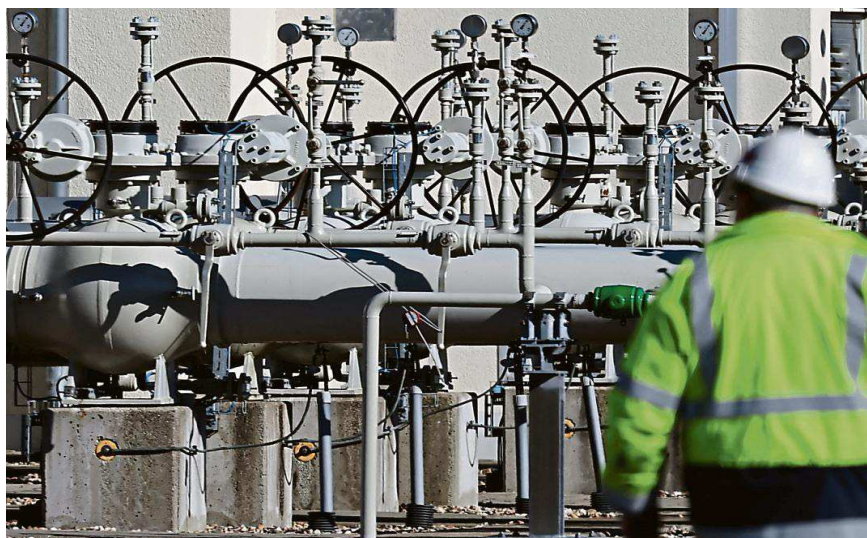
Une installation du pipeline Nord Stream 1 à Lubmin, en Allemagne. L'Union européenne importe chaque année l'équivalent de 155 milliards de m 3 de gaz russe. Photo Hannibal Hanschke/Reuters
