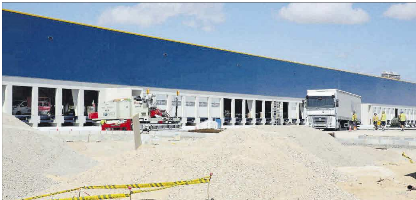
Obras de construcción de la nave de la empresa alemana Dachser, que dará empleo directo a cien personas en el puerto a partir de la próxima primavera.
