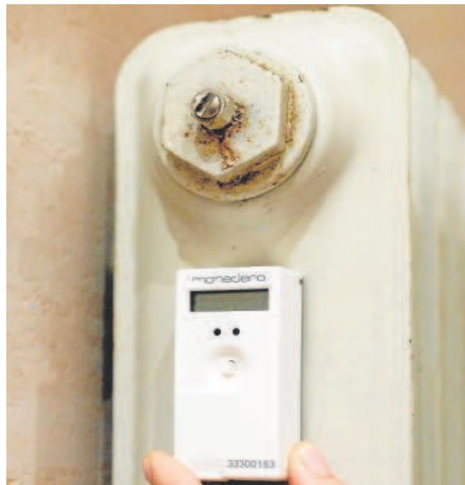
Radiador con el repartidor de costes obligatorio // ABC
